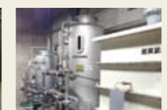
中水処理システム
