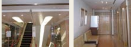
エスカレーター昇降口の上部に設けられたLED照明
